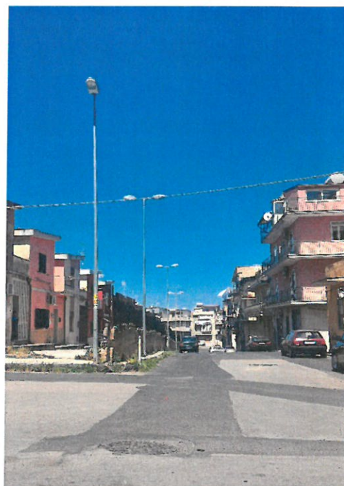
2 - Apparecchio installato tipo testapalo doppio
